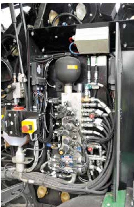
↑ Hydraulilohko on koneen vasemmalla puolella, kaikki toiminnot hallitaan sähköhydraulisesti samasta lohokosta.
